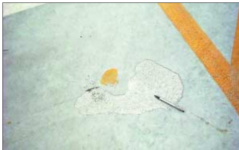
Figura 3.2: Aspectos da delaminação (Suprenant & Malisch, 1998)
